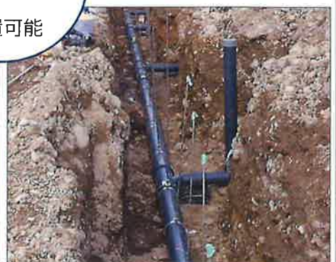
地中埋設配管
