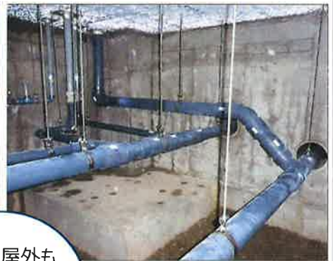
地下ピット配管
