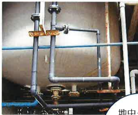
屋外露出配管
